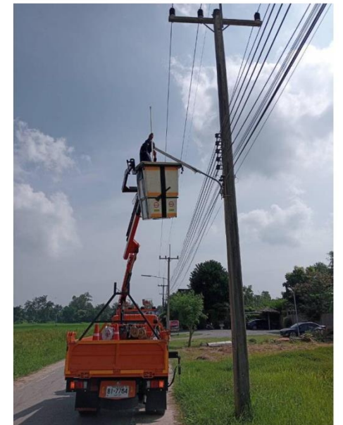
การปฏิบัติงานด้านไฟฟ้า : มีถุงมือและรถกระเช้าใช้ในการปฏิบัติงาน
